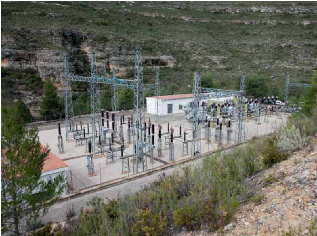
Exterior e interior de la Subestación transformadora
